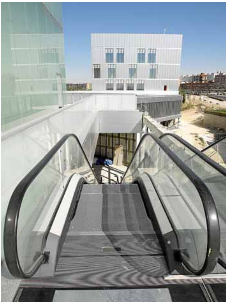
Una escalera mecánica une distintos espacios del centro.
